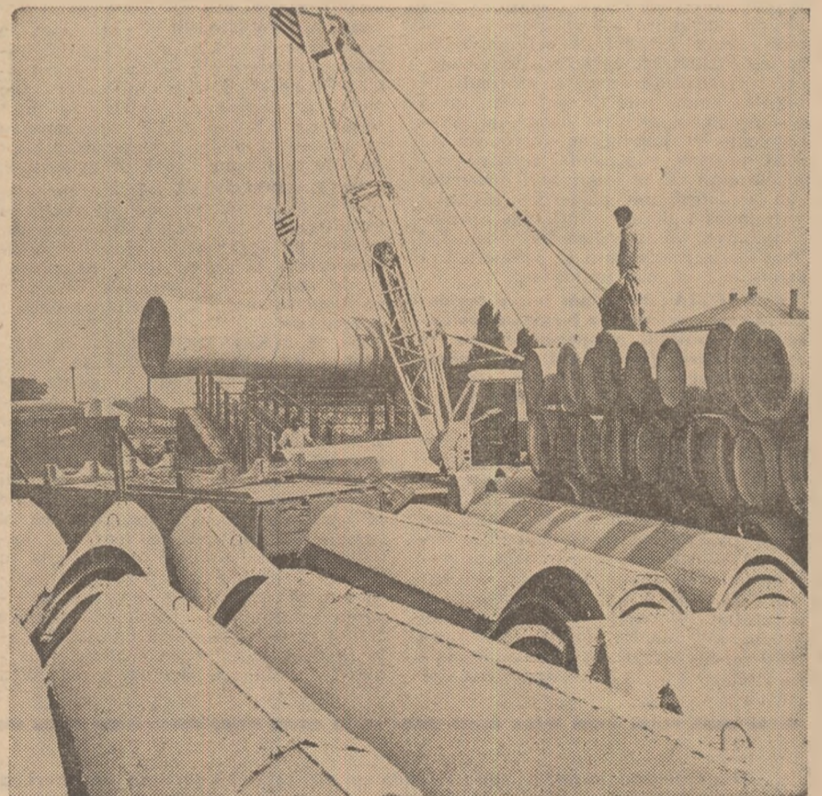
Pe șantierul de irigații Pietroiu-Perșoru din județul Ialomița, sosesc noi materiale — conducte și jgheaburi — destinate amenajărilor ce vor fi efectuate în anul în curs.
