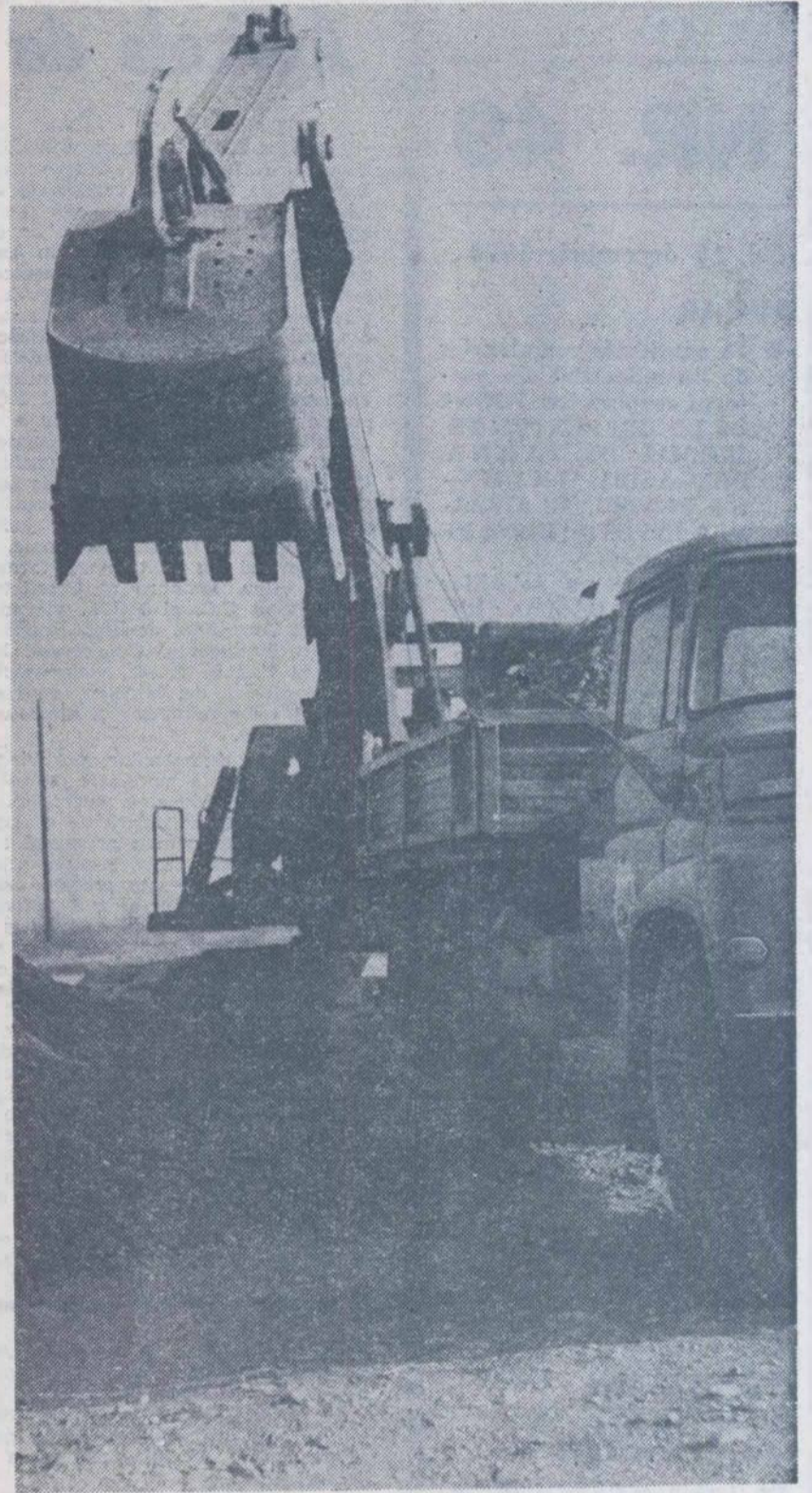
Lucrări de excavare la canalul de aducțiune a apei de la Paltinu, județul Prahova.
