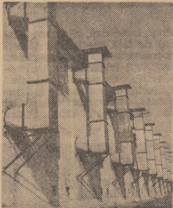
Instalații de aeraj la o fermă modernizată
