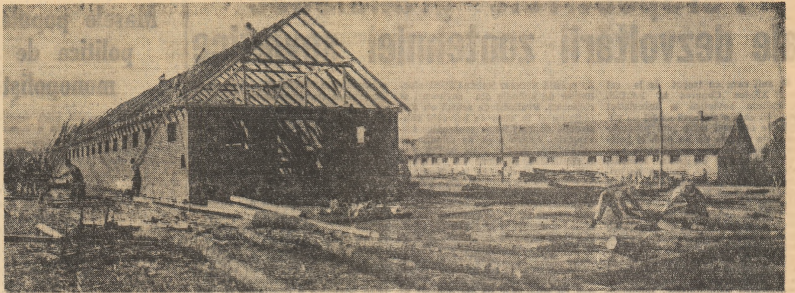
Gospodăria colectivă din satul Tebea, raionul Brad, regiunea Hunedoara, se dezvoltă cu pași repezi. Colectivității au ridicat numeroase construcții necesare avutului obștesc. Iată-l lucrînd, în aceste zile, la construirea a încă unui grajd pentru 100 de vite. Foto: AGERPRES
