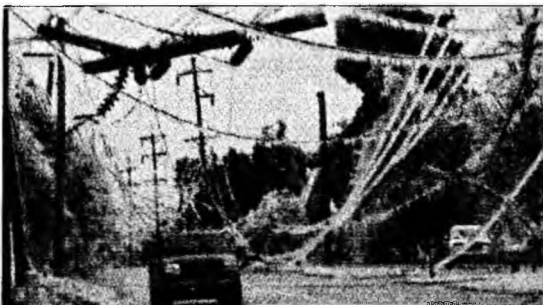
Au fost afectate liniile de înaltă tensiune (Foto: EPA)
