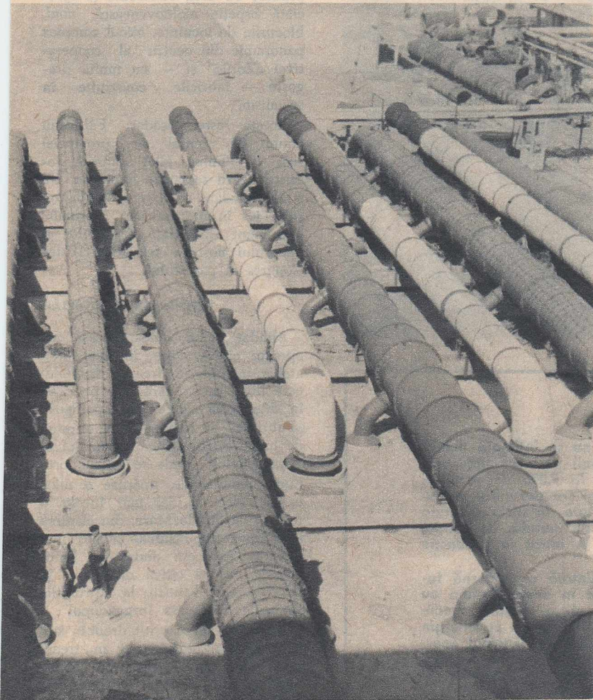
Pe aici, prin aceste moderne conducte, își fac drum gazele ce se recuperează la Combinatul de fibre artificiale din Brăila.
