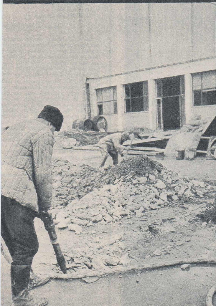
Ca să facă loc de scurgere pentru apa folosită la spălat în interiorul clădirii, constructorii sparg acum pardoseala exterioară (care a costat bani, bineînțeles).
