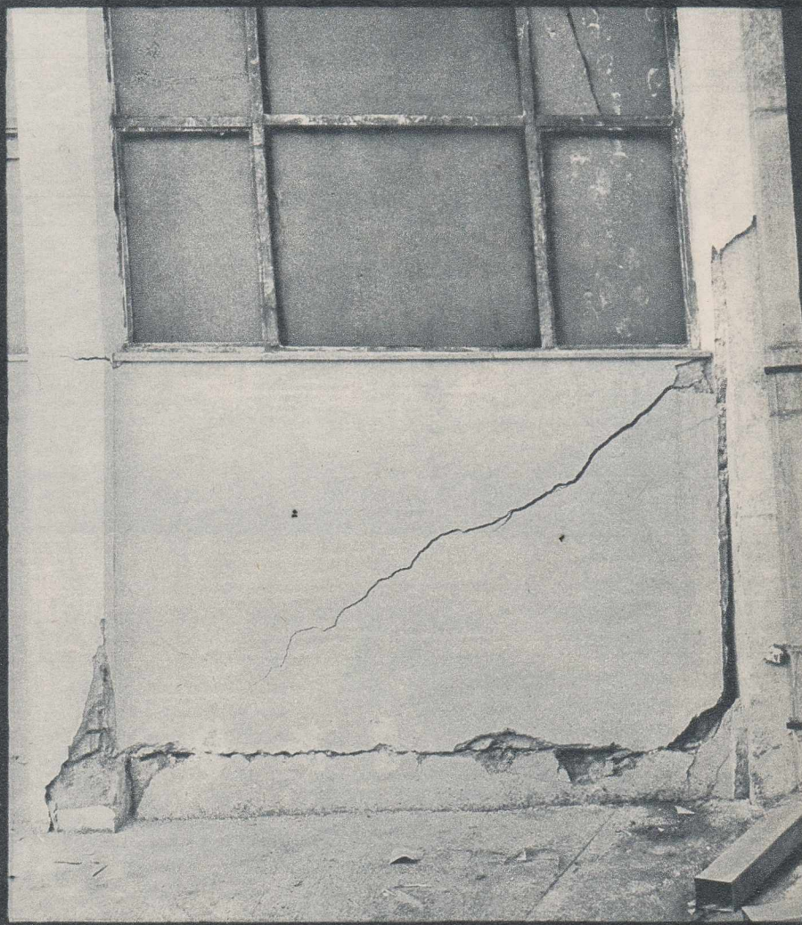
Zidul, nevoind să țină cont de calculele proiectanților, a luat-o din loc, fisurîndu-se pînă la degradare. Cine va plăti sumele necesare remedierilor?
