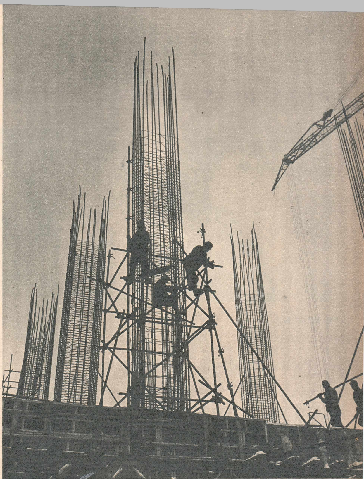
Peretele sălii de mașini, adevărată pavăză, cu o lungime și lățime ce depășesc zeci de metri.
