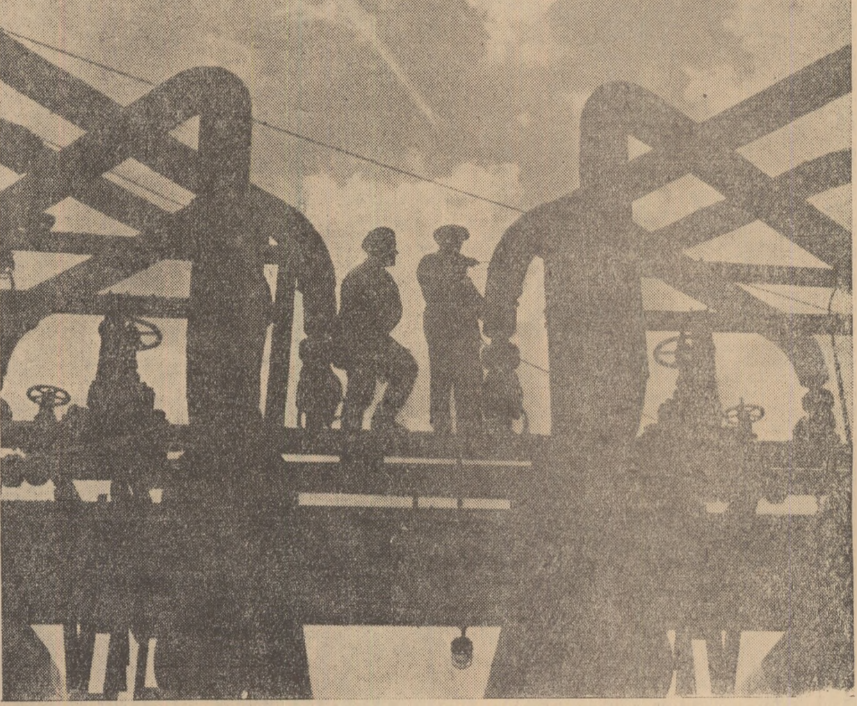
Rafineria Onești. Vedere parțială a noii secții pentru fabricarea cocșului din pudron. Foto EDMUND HÖFER
