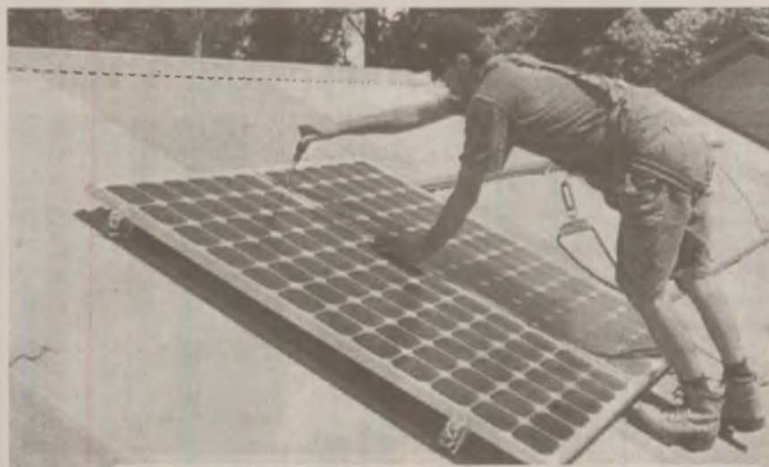
Pentru montarea unor instalații de panouri solare, solicitanții vor beneficia de o subvenție în valoare de 6.000 de lei
