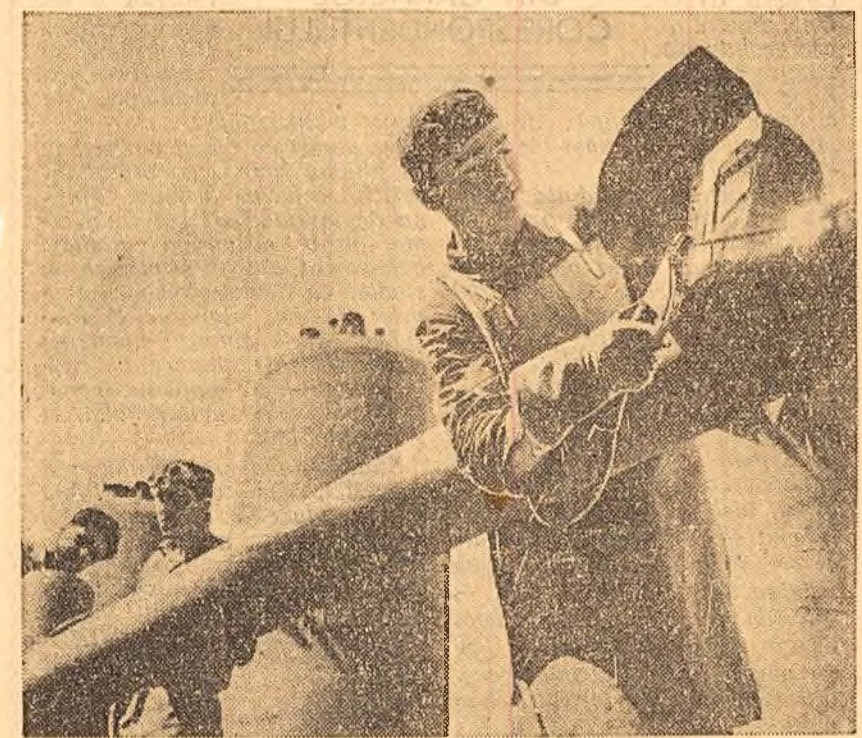
Șantierul combinatului de cauciuc sintetic din cadrul complexului Industrial Borzești. Sudorii Spirea Tudose, Ioan Anghel și Gheorghe Rodică lucrează la sudarea conductelor de la parcul de rezervoare al viitorului combinat. (Foto: Gh. Vințila)
