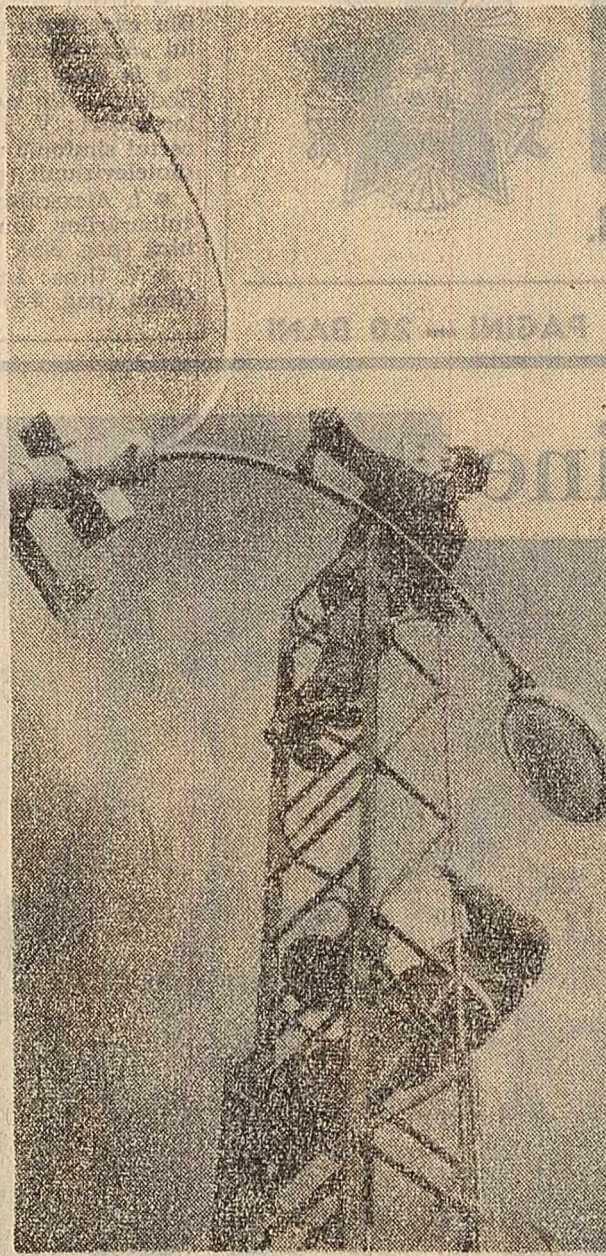
La Tg. Mures se extinde iluminatul public fluorescent. După terminarea lucrărilor de pe strada Gh. Doja, echipa de instalatori...
