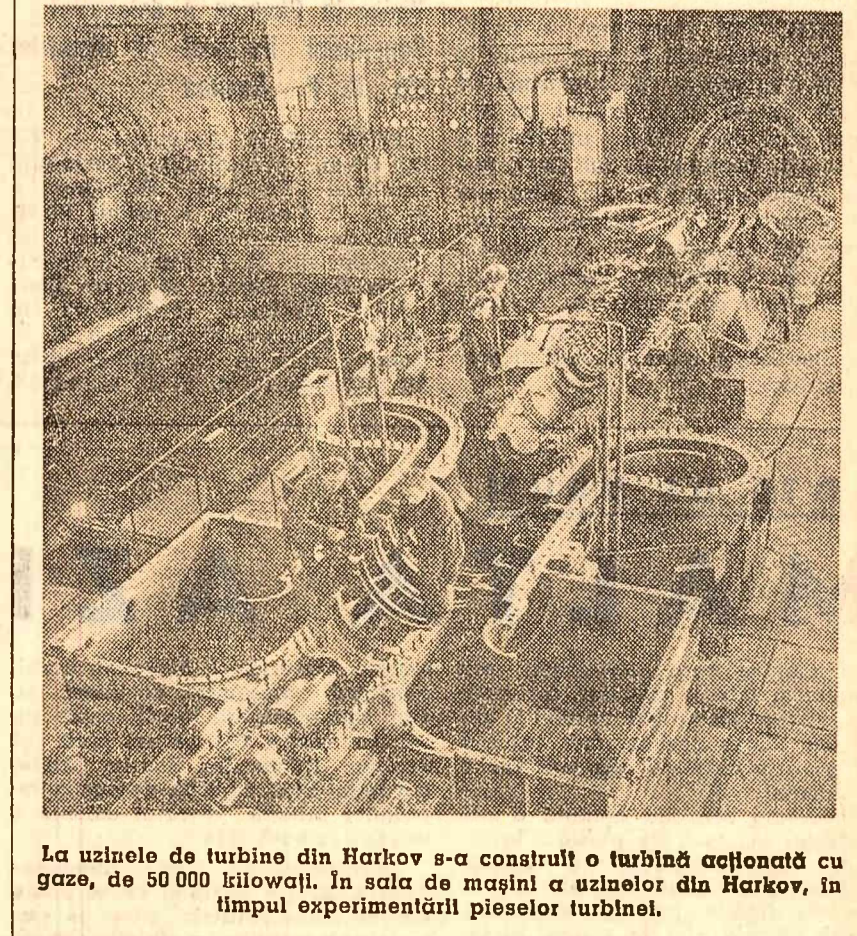
La uzinele de turbine din Harkov s-a construit o turbină acționată cu gaze, de 50 000 kilowați. În sala de mașini a uzinelor din Harkov, în timpul experimentării pieselor turbinei.
