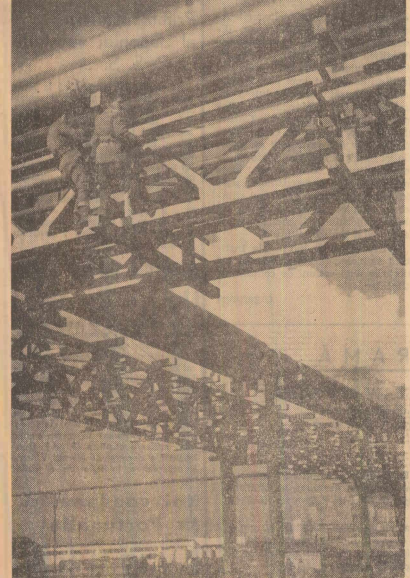
Combinatul petrochimic Ploiești. Montorii Mărgărit Stanciu și Alexandru Preda execută lucrările de montaj la o conductă pentru încălzire la estacada 1
