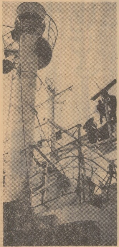
Santierul naval Galați. Se lucrează la instalarea radar a unui din cargourile de 4500 tone. Foto: Gh. Vintilă
