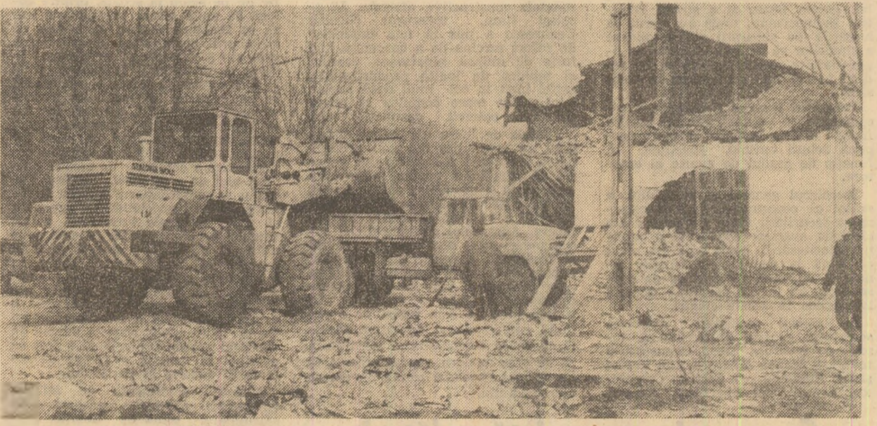
La intersecția străzilor V. I. Lenin și Giurgiului se pregătește terenul pentru viitoarele construcții
