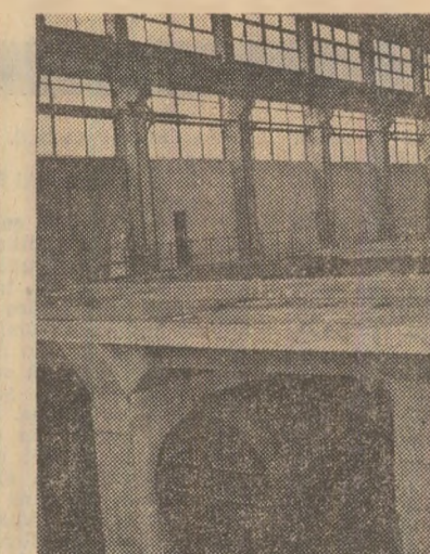
Lucrările de construire a estacadei centralei termoelectrice (fotografia din mijloc), în hola centrală de montaj din București pentru mașinile de scos și stivuit (fotografia din stînga), însă nu se grăbesc să le monteze la locul cuvenit
