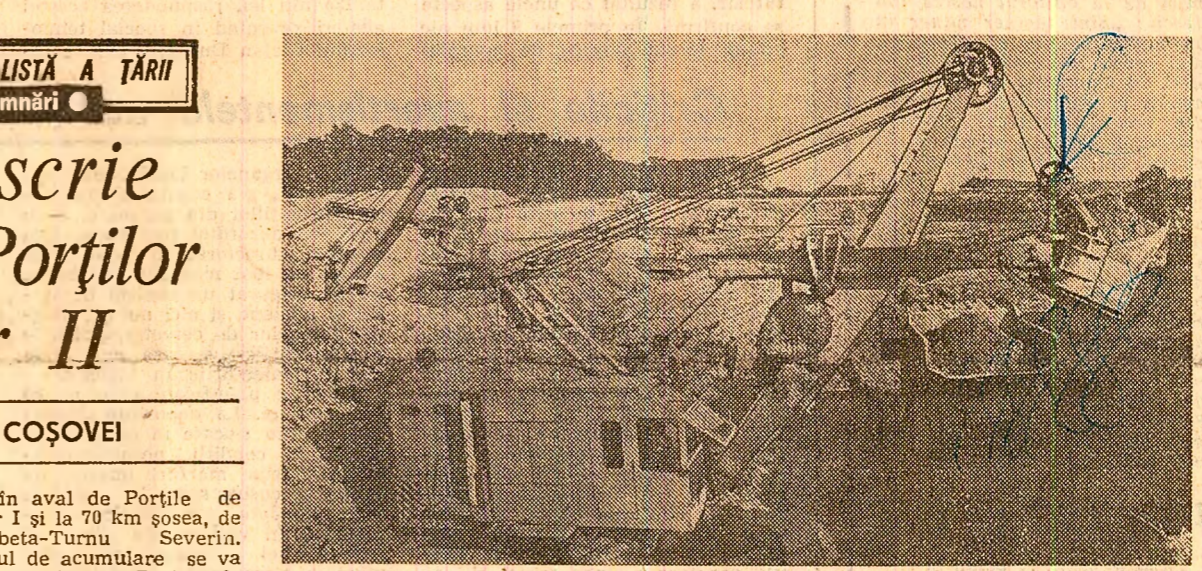
Porțile de Fier II. Se execută lucrări de excavații în ritm intens la barajul de pe brațul mic al Dunării în zona ecluzei românești și a centralelor electrice
