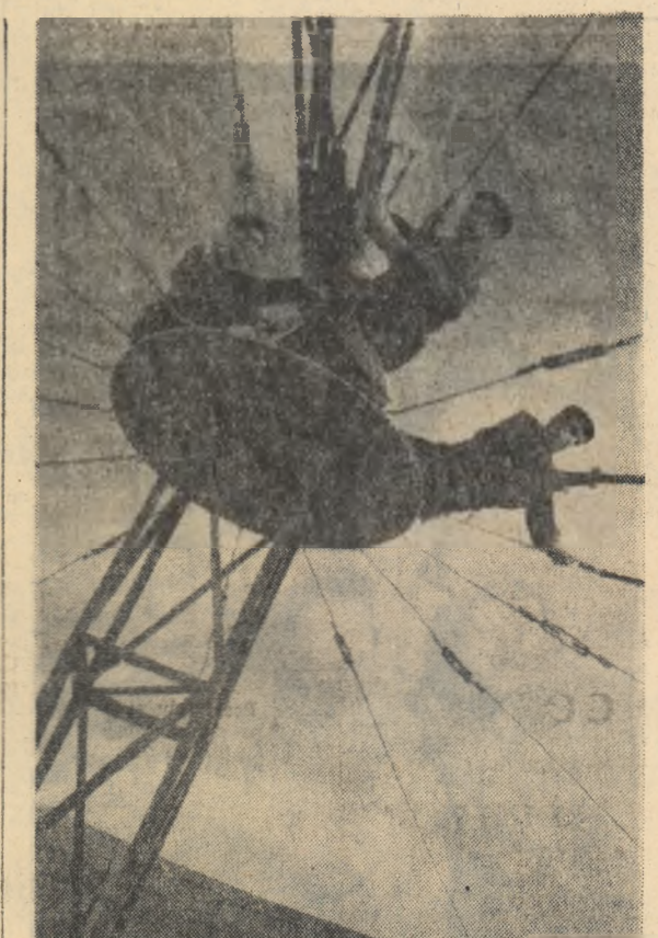
Institutul de cercetări în construcții și economia construcțiilor din Capitală. În fotografie: Aspect de la montarea mașinii pentru comprimarea rezervoarelor din beton armat.
