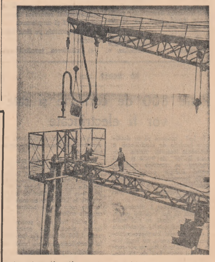
În regiunea de unde se extrage petrolul din Marea Caspică, se construiește o estacadă maritimă cu o lungime de 500 m. Foto: TASS-MOSCOVA
