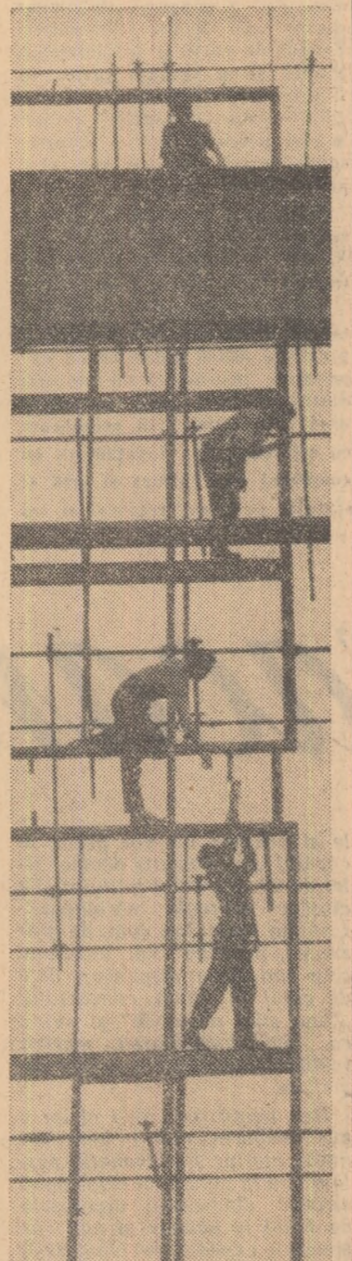
Deocamdată sînt numai rame, dar în curînd prin gemurile mari, lumina va pătrunde din belșug în noua hală ce se construiește la Întreprinderea de poduri metalice și prefabricate din beton-Pitești
