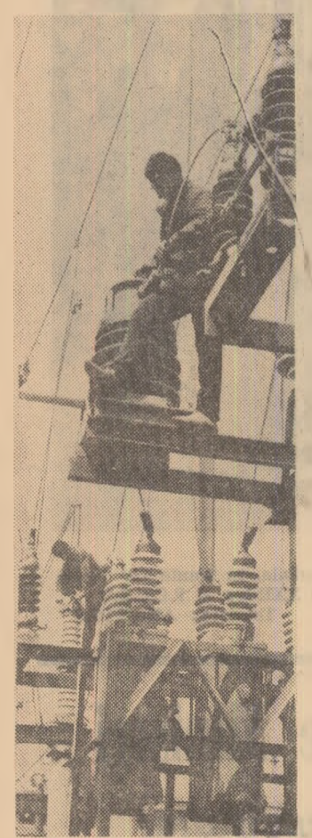
Se lucrează intens la montarea stației electrice de 35/15/6 kW din Baciu, regiunea Cluj
