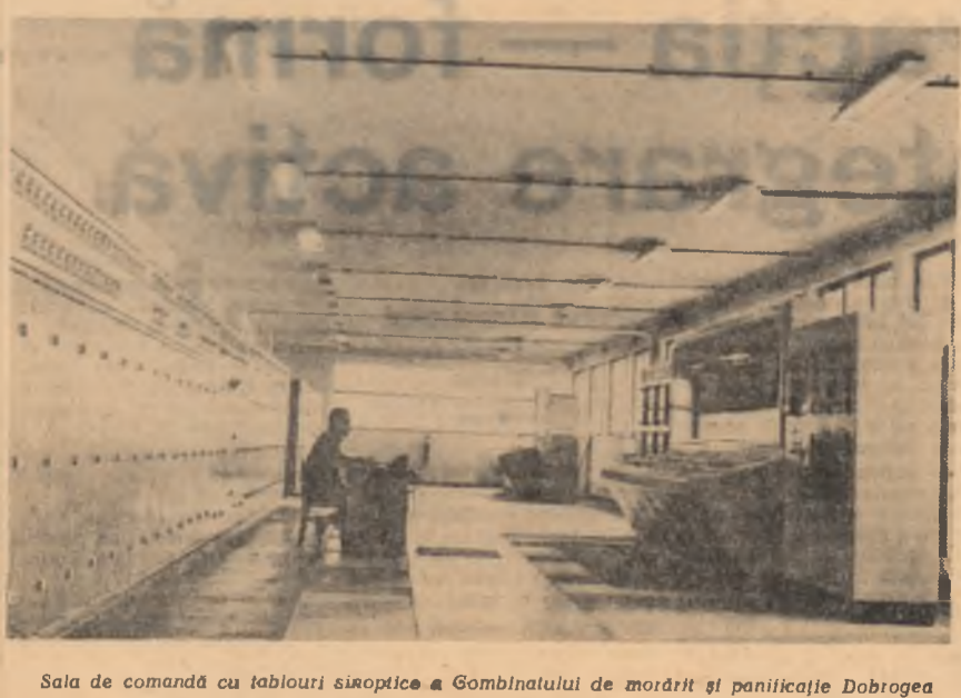
Sala de comandă cu tablouri sinoptice a Gombinatului de morărit și panificație Dobrogea
