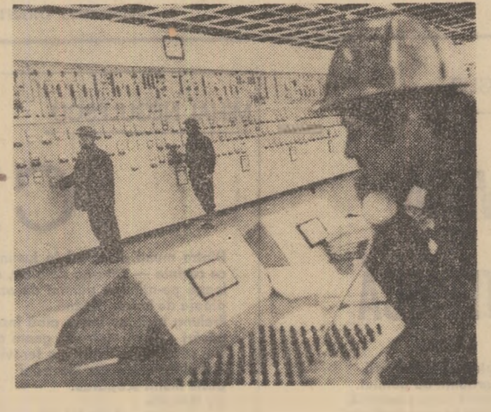
La unul din modernele tablouri de comandă de la Combinatul petro-chimic Pitești. Foto: O. PLECAN
