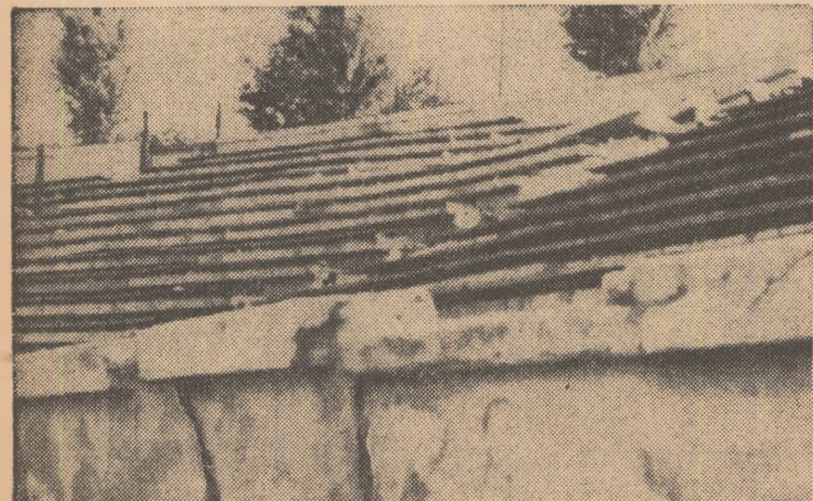
Știți ce reprezintă fotografia de față? Un colț al tribunei stadionului orașenesc din Bacău. Ce păcat că această frumoasă bază sportivă nu este întreținută ca lumea. Se degradează băncile peluzelor, se crapă zidul din fața tribunei etc. Sîntem convinși că harnicii gospodari din Bacău, care au transformat orașul lor în ultimii ani într-o adevărată bijuterie, nu vor lăsa în această situație stadionul lor.
