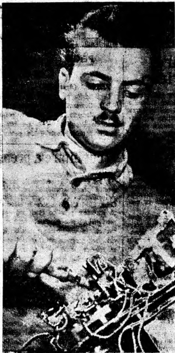
Comunistul Laezko Zoltan, electrician la mina Lopea 2, lucrează la repararea unui întrerupător de mină.
