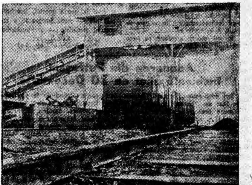
Un nou obiectiv pus în funcție de curînd: instalația de încălzit cărbune în vagoane C.F.R. de la mina Dilja.
