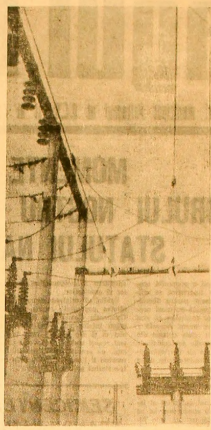
Arlere aeriene de energie electrică
