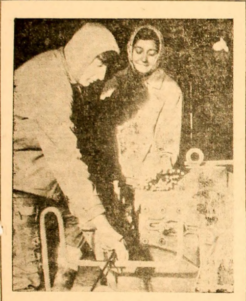
Tinerii fierar-betonisti de la Poligonul de prefabricate Livezeni Tatiana Ciocoiu și Constantin Nichita pregătesc o „armură” pentru viitorii pereți ale viitoarelor locuințe.
