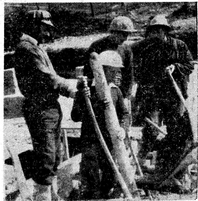
Betonistii din echipa condusă de Mihai Sava din Vulcan, lucrează în ritm susținut la turnarea fundației blocului 3 B ce va avea în final 8 nivele și 64 de apartamente.
