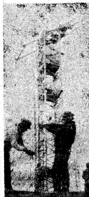
Lupeni, șantierul T.C.H. Fierar-betonistii din echipa condusă de Gheorghe Ristea „tes” împletitura metalică a blocului K4 din cartierul Viscoza.
