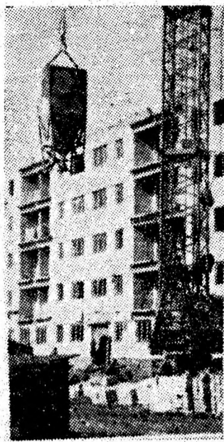
Instantaneu de muncă de pe șantierul construcțiilor de locuințe din orașul Lupeni.
