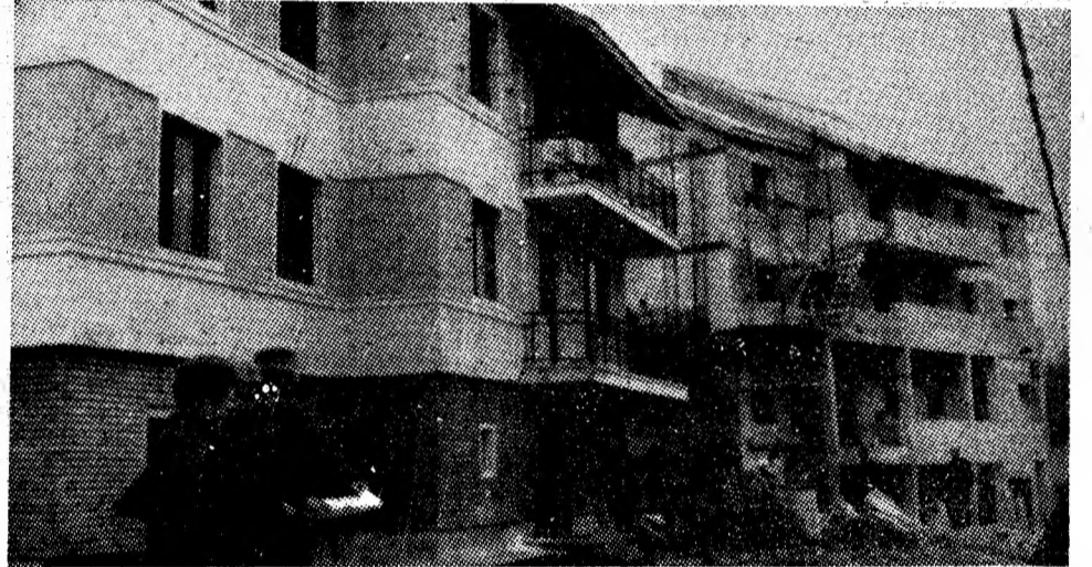
La Bănița, deputații, în mijlocul constructorilor, într-un dialog despre finalizarea la termen a noilor blocuri de locuințe.
