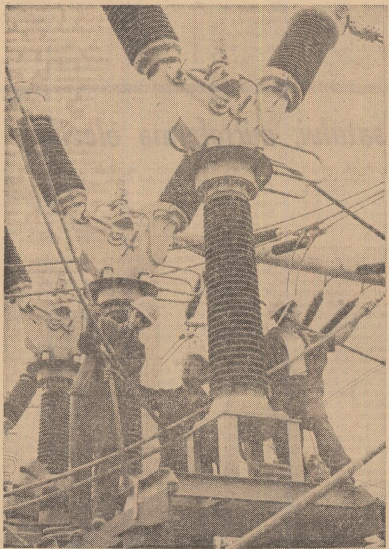
Stația de transformare a curentului de la Fabrica de pîșe radio din Curtea de Argeș
