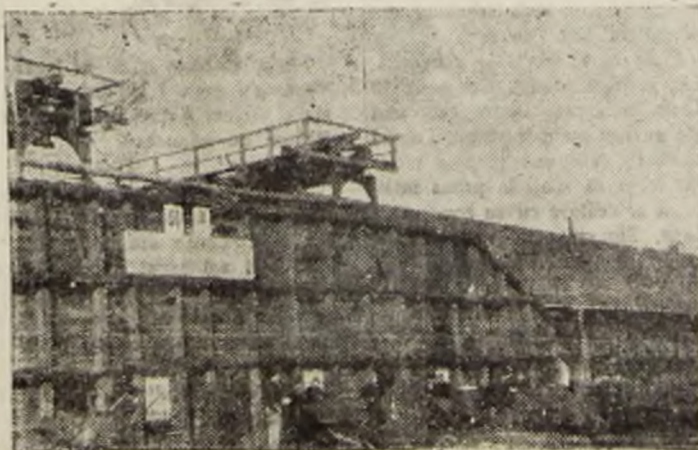
Vechile silozuri pentru minereu și calcar sunt golite pentru a se face loc pentru altele, mai mari, din beton, adecuate viitorului sistem de alimentare a furnalelor.
